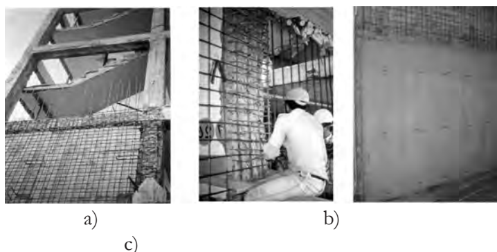
Fotos 9. a), b) y c) Sistema de reforzamiento con pantallas en concreto.
