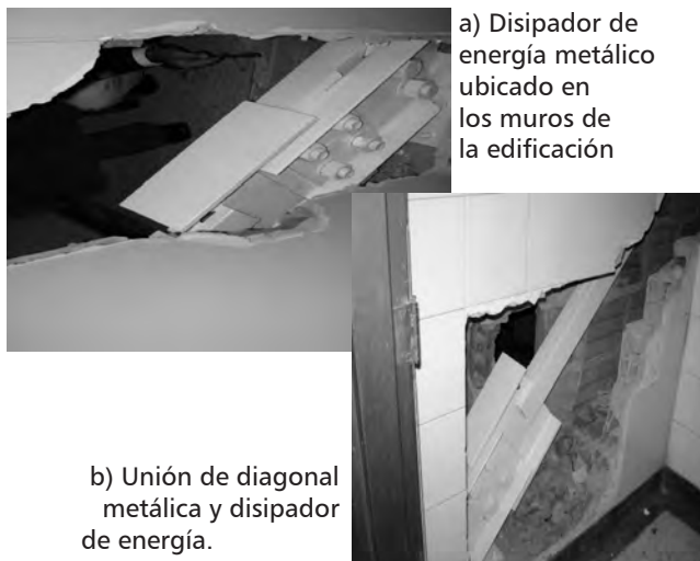
Foto 7a) y b). Reforzamiento con disipadores metálicos y diagonales metálicas. Hospital El Tunal, Bogotá.
