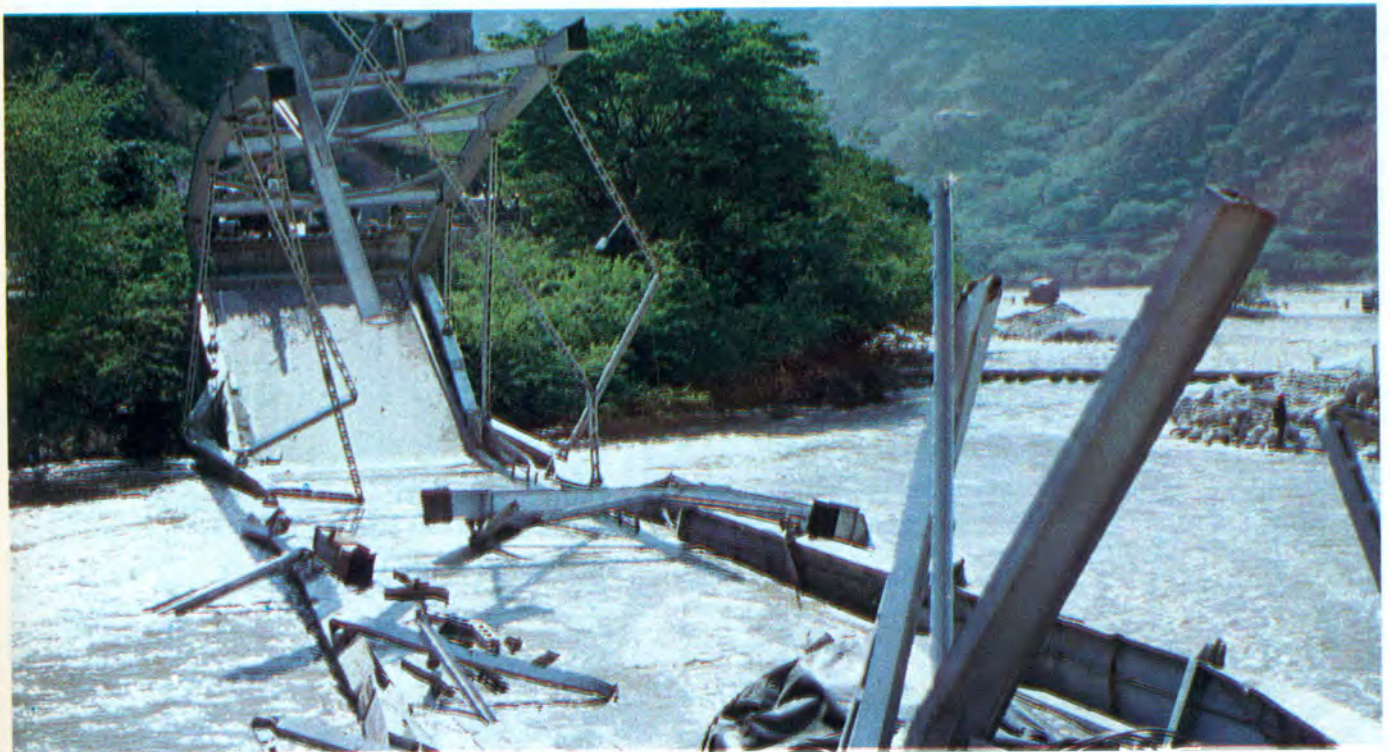
Puente de Pescadero colapso. Enero 7/96.
