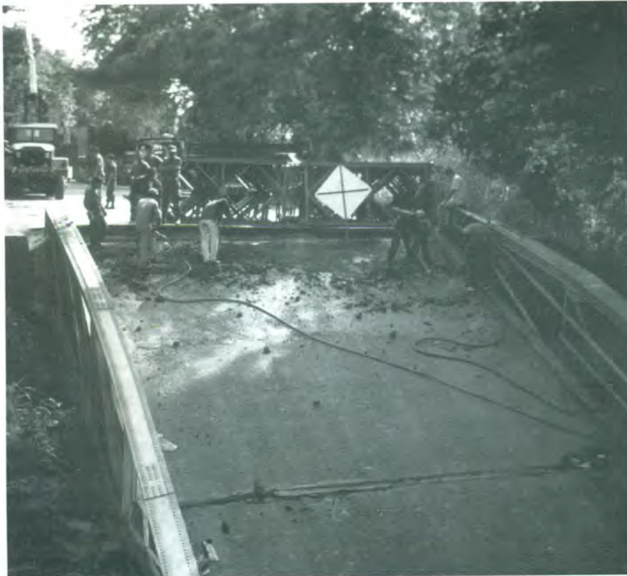
Colapso del Puente de Purnio, enero 18 de 1996.
