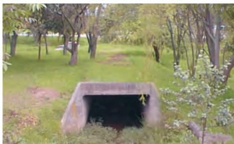
Autopista Norte (2004). Obras transversales de drenaje inutilizadas.
