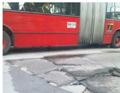
Deterioro típico del pavimento rígido de Transmilenio.
