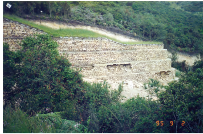
Fotografía 6. Daños locales ocurridos luego del sismo de 1995.
