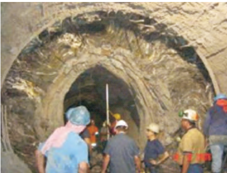
Fotografía 1. Sección de un túnel con problemas de squeezing .
