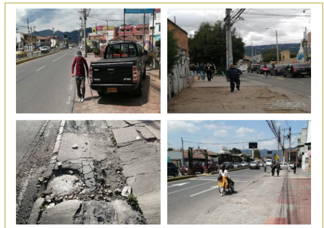
Figura 4. Situaciones críticas en la avenida Pradilla 1.
