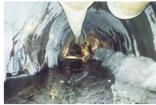
Fotografía 12. Flujos y avalanchas de material hacia la excavación en el túnel de fuga. Tomado de Experiencias de excavación de túneles con métodos convencionales y máquinas TBM en la cordillera de los Andes. Casos históricos. C. Marulanda (2015).
