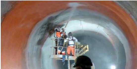
Figura 7. Aplicación en dos colores de la membrana impermeabilizante (primera capa de color naranja, segunda capa de color blanco).
