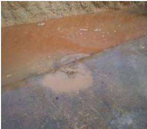
Fotografía 7. Resurgencias de agua en la perforación por efectos de la presión artesiana.
