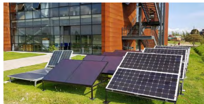
Figura 12. Paneles instalados en el Laboratorio de Energía en el edificio I.
