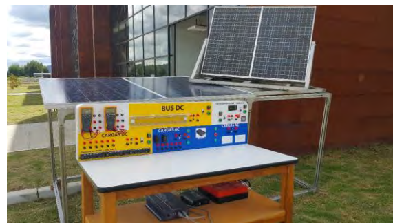
Figura 8. Sistema off grid de la Escuela Colombiana de Ingeniería Julio Garavito.
