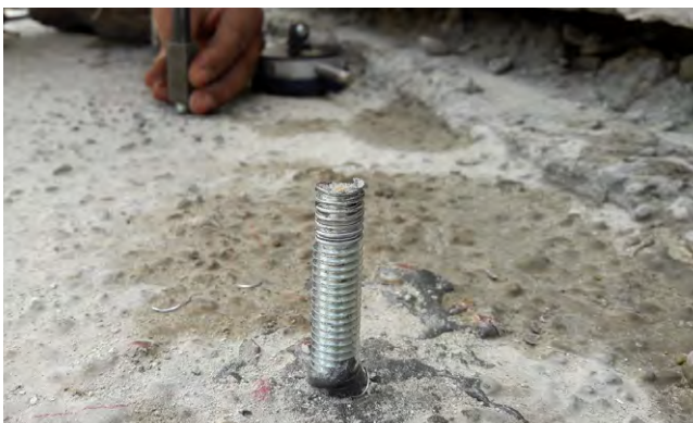
Figura 7. Anclaje \phi 3/8'' después de ensayo confinado a tensión. Falla del acero.
