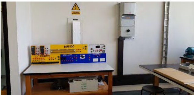
Figura 6. Sistemas fotovoltaicos off grid y on grid de la Escuela Colombiana de Ingeniería Julio Garavito.
