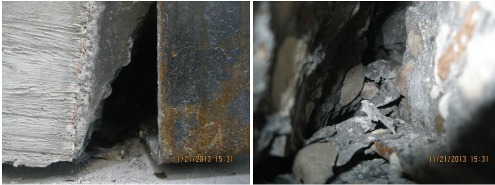
Figura 7. Imágenes de la falla.
