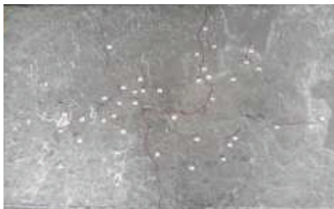
Figura 4. Aspecto de una losa con esquema de fisuración después del tiempo de ensayo.
