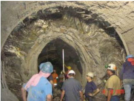
Fotografía 1. Sección de un túnel con problemas de squeezing .
