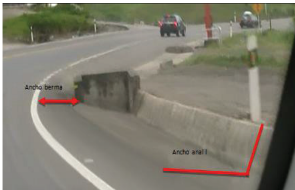
Figura 13. Elementos peligrosos a borde de carretera.
