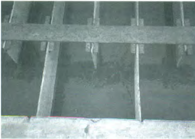
Figura 2. Floculador hidráulico de flujo horizontal con tabiques en asbesto-cemento (2).
