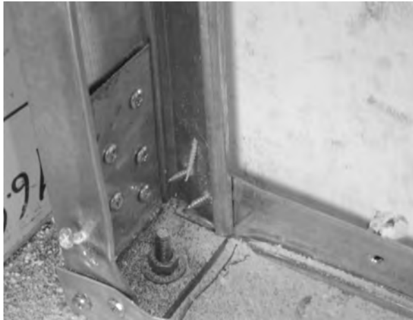
Figura 11. Detalle de anclaje sísmico (foto cortesía del ingeniero Alejandro Rico, ref. 1).
