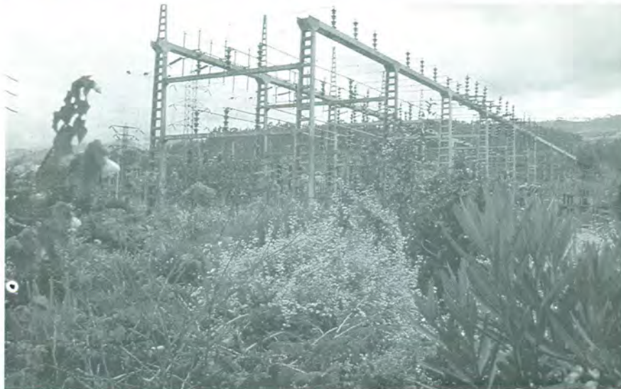
Subestación Eléctrica Termopaipa.
